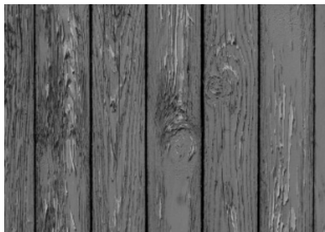
Figura 7: Tinta queimada após aplicação incorreta do soprador térmico.
